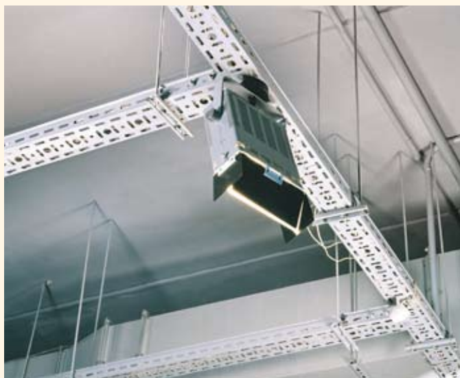
Кабельная трасса из лотков
