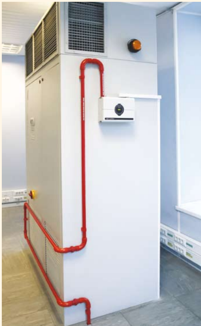
Пример установки аспирационной системы в ЦОДе
