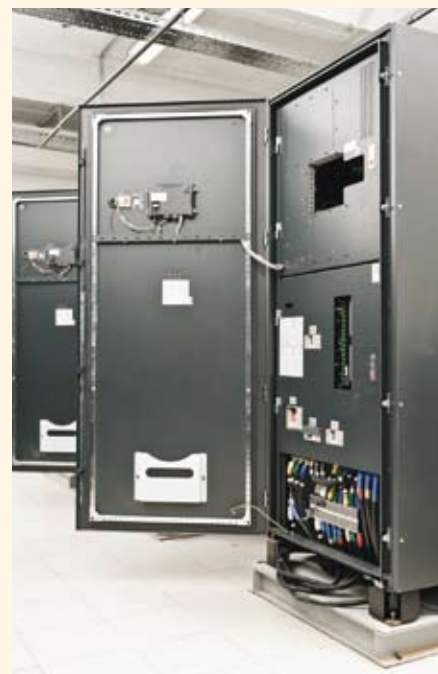
ИБП Powercom ONL-33-II (120 кВА)
