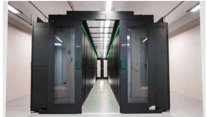
Система изоляции воздуха горячего коридора
